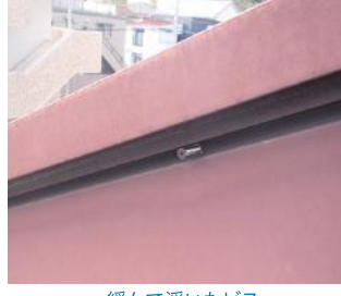
緩んで浮いたビス
