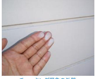
チョーキング現象の外壁
