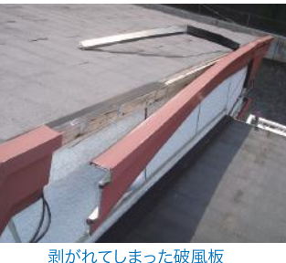
剥がれてしまった破風板
