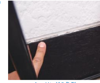
シーリングの亀裂
